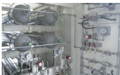
蓄圧器ユニット内部
