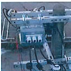
柱上気中開閉器及び 地絡継電器
