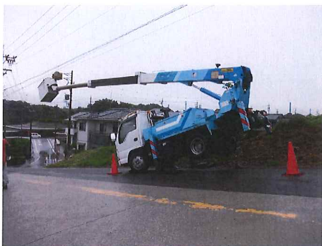
前方に倒れた高所作業車（側方より）
