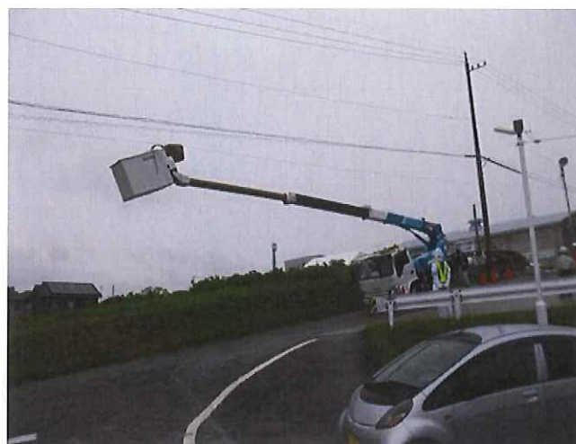
前方に倒れた高所作業車（前方より）
