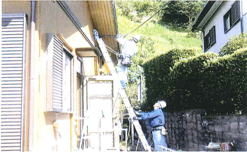
60エ491 梯子の転倒防止上部固定が出来なく、下でささえて転倒防止に努めている。
