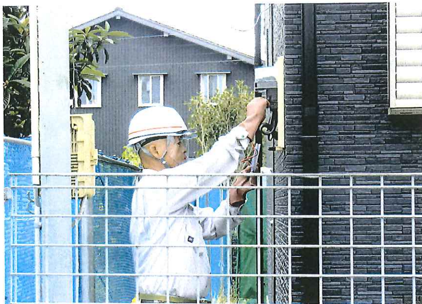
電圧確認は安全マスク・低圧手袋使用で確認
