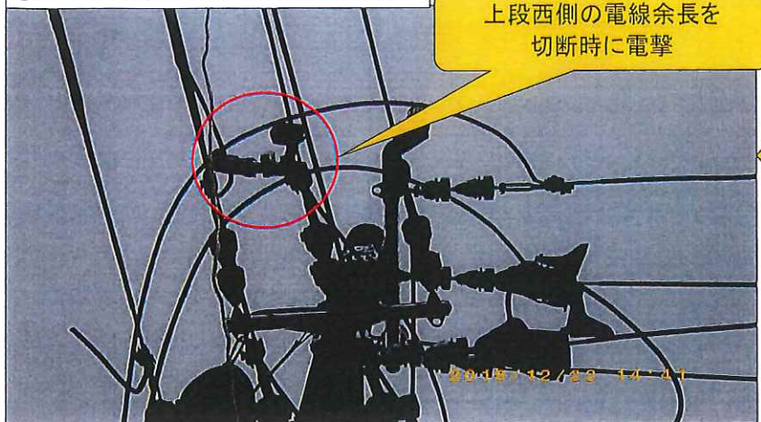
②22工631号柱(12/22事故発生時撮影)
