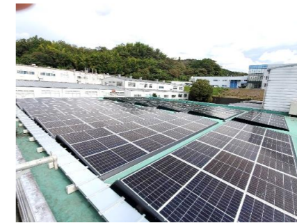
太陽電池モジュール(PV) 西側
